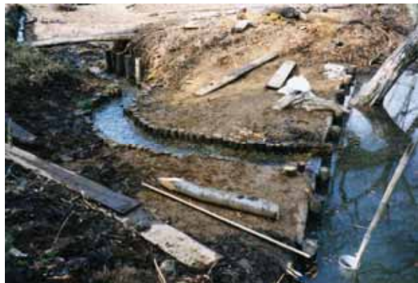
伝統的工法により整備された水路
